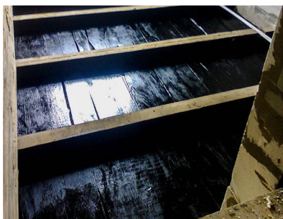
Рисунок 6 а - Деревянные конструкции, покрытые битумным лаком.
