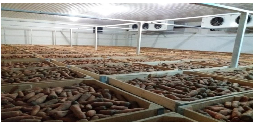
Рисунок 3. Размещение моркови в контейнерах и воздухоохладителей в охлаждаемом помещении овощехранилища ТОО «Бирлик - 4».
