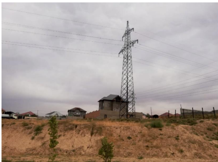
Рисунок 3- Общий вид опоры и ВЛ-110 кВ установленной в микрорайоне Нұрсәт
