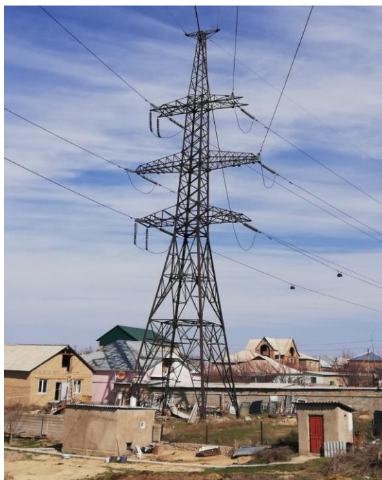
Рисунок 4 - Общий вид опоры и ВЛ-110 кВ установленной в микрорайоне Казыгурт
