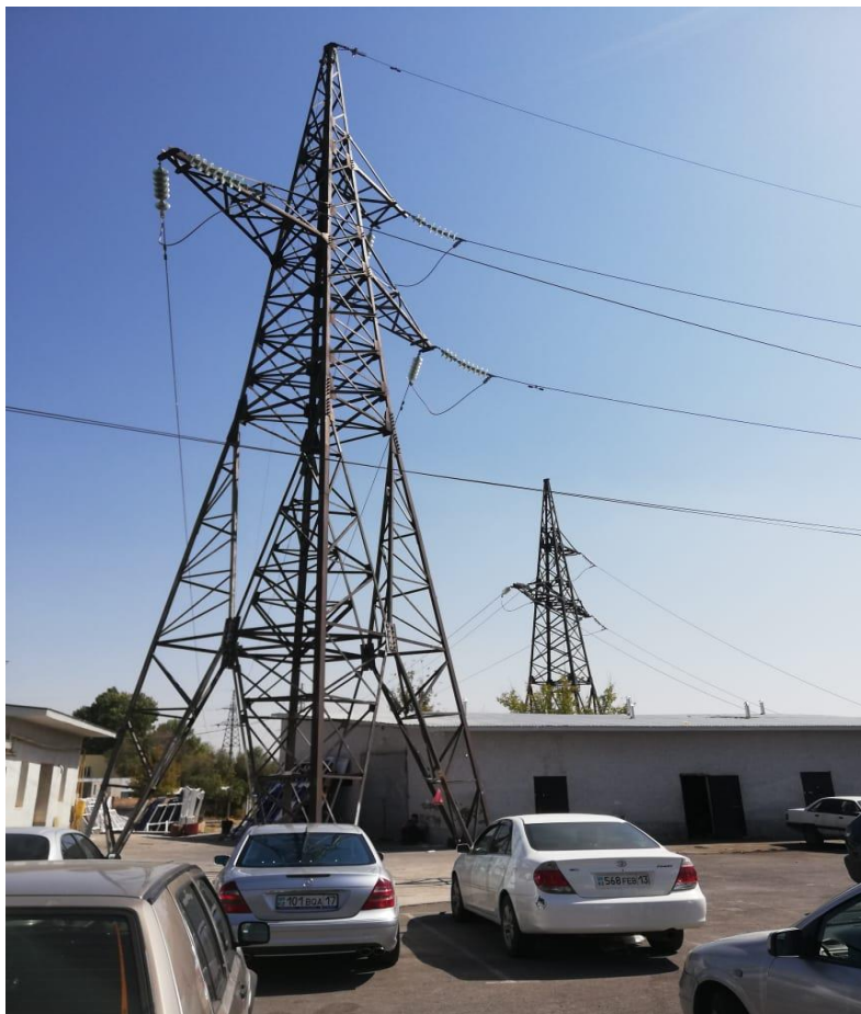
Рисунок 2- Общий вид опоры и ВЛ-110 кВ, установленной в микрорайоне Жібек жолы
