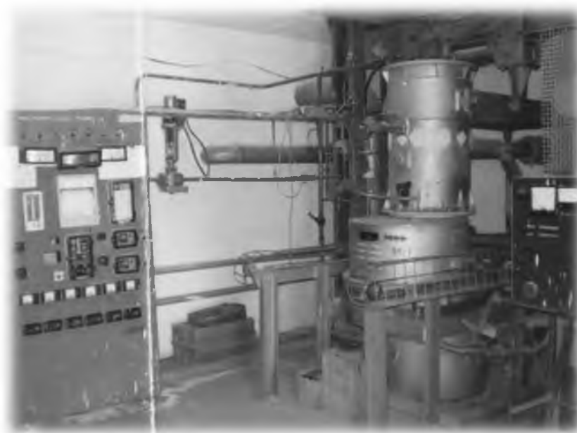
Рисунок 14 – Общий вид опытной установки обжиговой чаши объёмом 0,3 м 3
